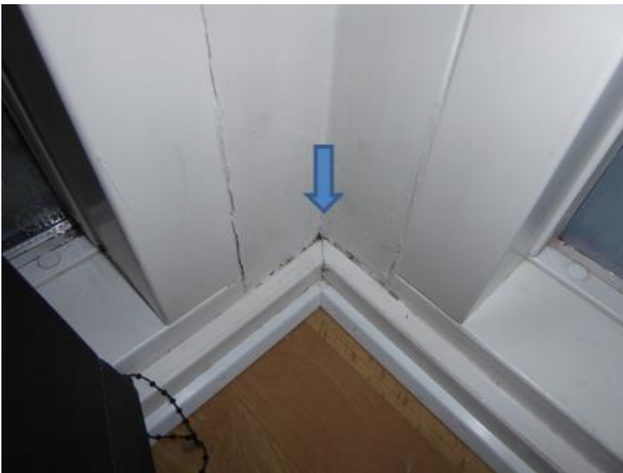
Foto nr. 05. Stue: Misfarvninger på fodpanel/væg i karnap.
