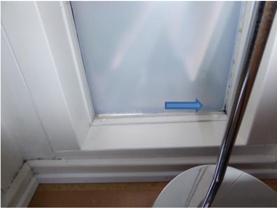
Foto nr. 06. Stue: Misfarvninger på fodpanel/væg i karnap.
