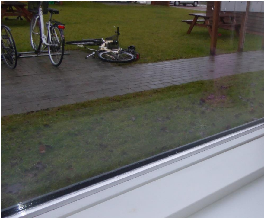
Foto nr. 01. Værelse: dug/vand på ruder
